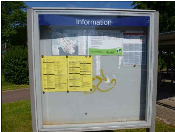
Abbildung 28: Die Rückwand der Vitrine an Gleis 1 in Einfeld ist beschmiert und mit offenbar nicht zu reinigenden Kleberesten versehen.
