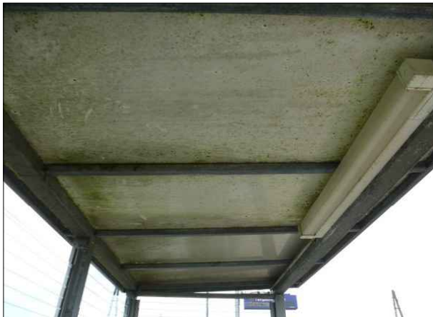
Abbildung 7: In einigen Fahrgastunterständen sind die Decken stark verschmutzt. Auch im Unterstand von Jarrenwisch ist das zu erkennen.
