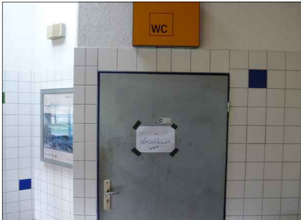
Abbildung 38: Die WC-Anlage in Sierksdorf war aufgrund defekter Türschließungen gesperrt.
