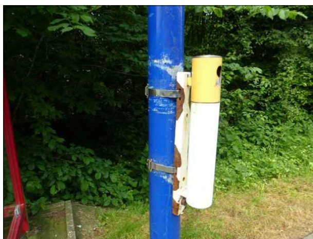
Abbildung 15: Unansehnlich ist die verrostete Halterung des Aschenbechers auf dem Bahnsteig in Süderlügum.
