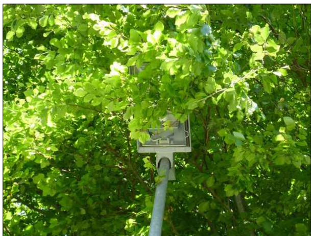
Abbildung 46: In Einfeld waren mehrere Lichtköpfe der Bahnsteigbeleuchtung zugewachsen.
