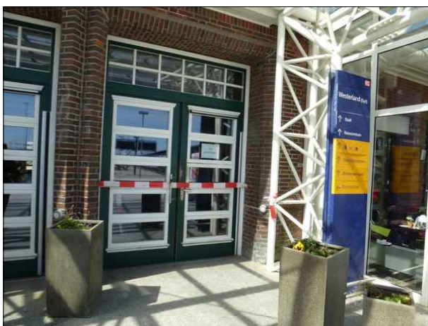
Abbildung 36: In Westerland waren erneut defekte Türen des Empfangsgebäudes gesperrt.
