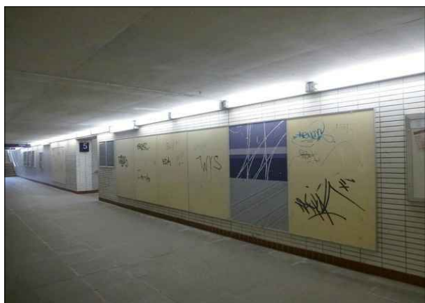
Abbildung 45: Bis auf eine waren alle Tapeten der Graffitischutzboards in Pinneberg abgerissen. Zudem waren die Boards bekratzelt.
