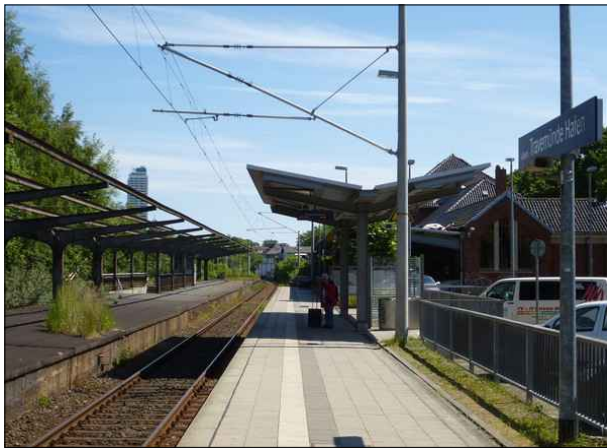
Abbildung 49: Die angerosteten Dachstützen und -träger auf dem nicht mehr nutzbaren Bahnsteig in Travemünde Hafen beeinträchtigen die Aufenthaltsqualität an der Station.
