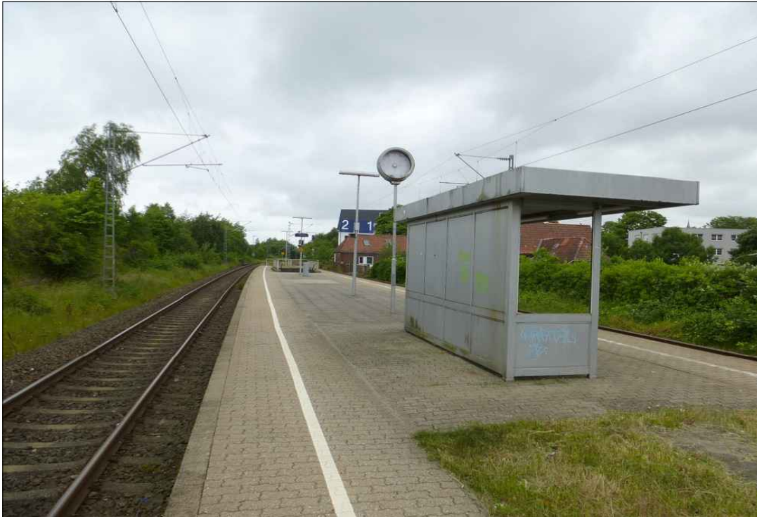
Flensburg-Weiche: Bahnhof an der Strecke Neumünster - Flensburg: Am Unterstand fehlten die Scheiben und es gab Schmierereien. Auch die Uhr war zerstört.
