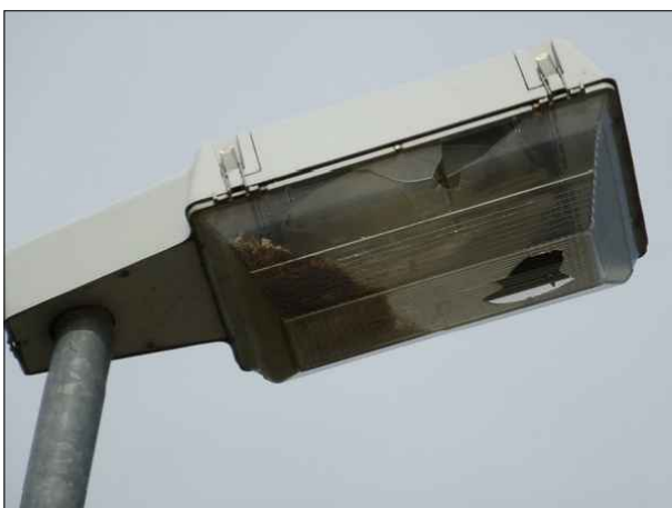
Abbildung 47: Diese Lampenhaube in Gokels ist beschädigt und daher innen durch zahllose Insekten verschmutzt.
