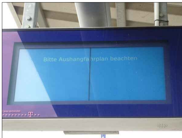
Abbildung 17: Der Zugzielanzeiger an der Wartehalle in Fehmarn-Burg war defekt.
