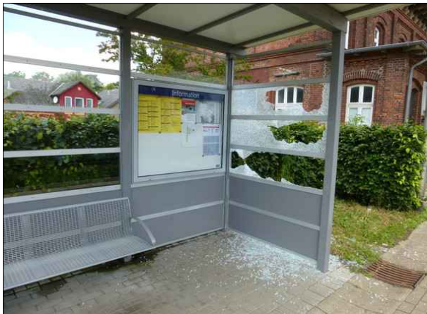
Abbildung 22: Drei Scheiben dieses Unterstands an Gleis 1 in Krempe waren zerstört.
