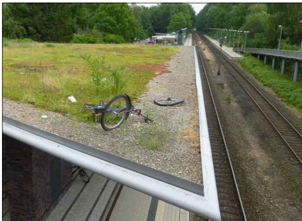
Abbildung 50: Auf dem Dach des Bahnhofsgebäudes von Scharbeutz liegen Müll und ein Fahrradwrack.
