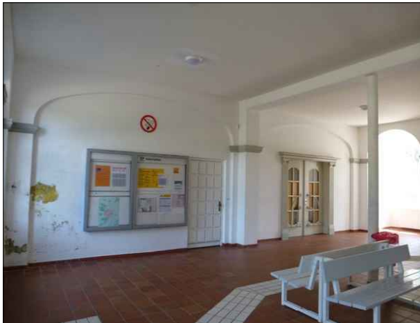
Abbildung 34: Die stark bekritzelten Wände im Warteraum des Empfangsgebäudes von Burg wurden neu gestrichen. Die Feuchtigkeitsschäden blieben.
