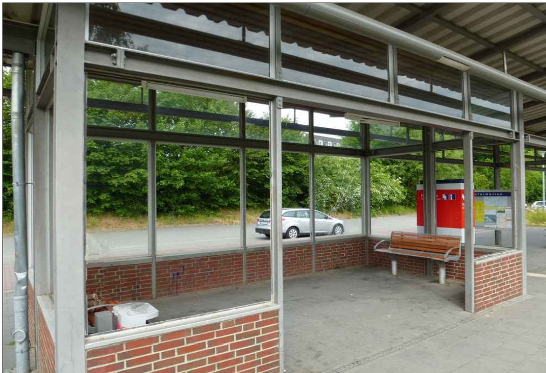
Lensahn: Haltepunkt an der Strecke Lübeck - Puttgarden: Im Wetterschutz fehlten fast alle Scheiben. Zudem gab es weitere Schäden sowie Verschmutzungen. In den Bereichen „Information“ und „Service“ wurde dagegen kein Mangel verzeichnet.
